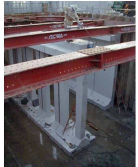
La figura 4 illustra il metodo di raccordo sul cantiere. Gli elementi a forma di "I" vengono raccordati con la tecnica di precompressione per garantire la sicurezza antisismica.
